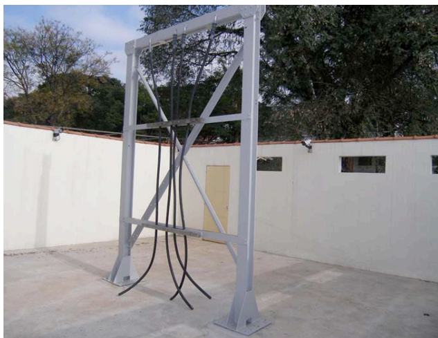
Figura 2 – Pórtico utilizado nas subestações da Elektro instalado na área experimental do Instituto Butantan
