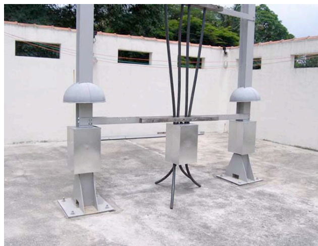
Figura 3 - Barreiras físicas de fibra de vidro em forma de meia-lua, instaladas nas vigas em I, e caixas de chapa galvanizada, fechadas no topo, envolvendo os cabos emborrachados e as bases das vigas em I do pórtico
